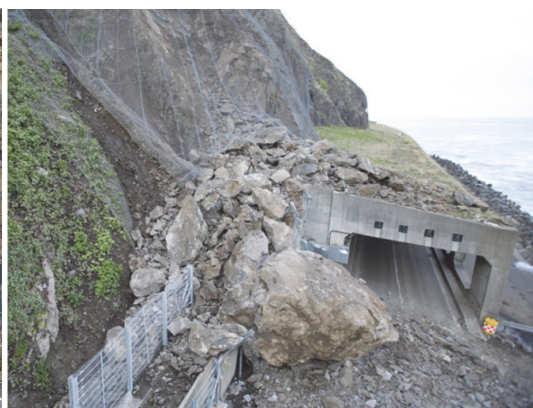
写真-1.2 落石による被災事例 (2008)
