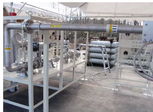
図 2 GG-ATR エンジン冷走試験設備
