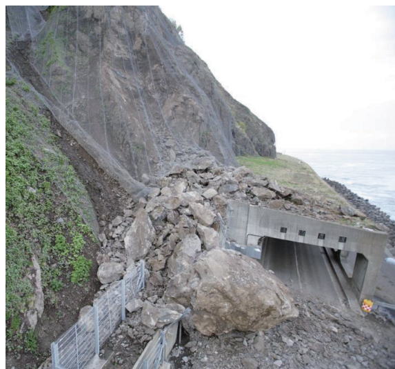
写真-1 落石による道路災害例 (2008)
