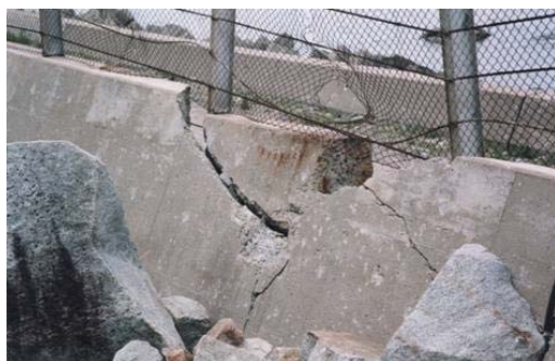
写真 - 1 落石防護擁壁の損傷事例
