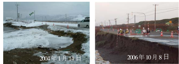
(a)被害事例1 (A地区) (b)被害事例2 (B地区)
