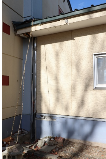
写真 2.4 校舎と体育館の渡り廊下の EXP. J. の被害(C2)
