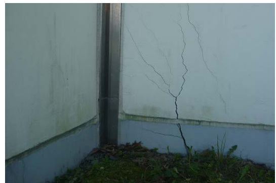
(b) 基礎梁から壁に伸びるひび割れ
