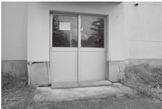
写真 3.6 1F 出入口の損傷
