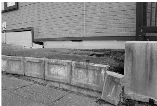
写真 3.24 基礎梁の損傷
