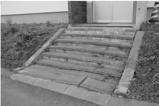
写真 3.22 地盤変動に伴う外階段の変状
