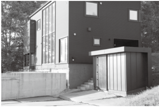
写真 3.3 擁壁の沈下・水平移動
