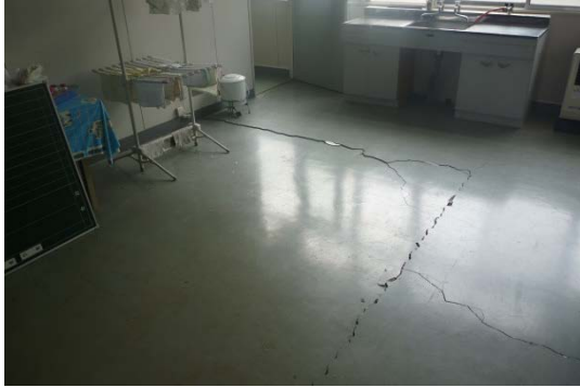
(a) 床に生じたひび割れ
