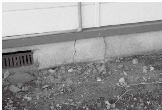
写真 3.20 基礎に一部ひび割れ
