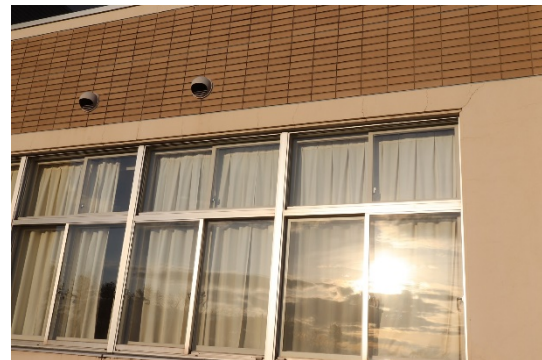
(b) 開口部周囲のひび割れ
