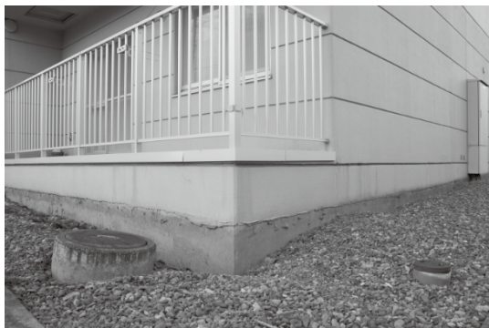
写真 3.13 地盤沈下と基礎に一部ひび割れ
