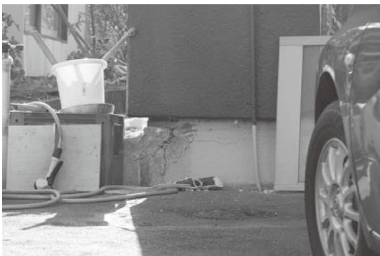
写真 3.8 基礎隅角部の損壊
