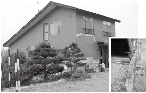
写真 3.17 傾斜地に建つ住宅と擁壁の被害
