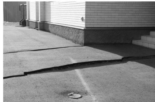
写真3.2 建物敷地内に生じていた地割れ
