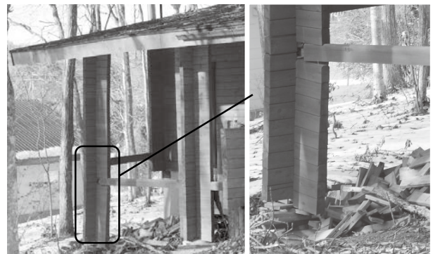
写真 3.11 地盤のすべりによって谷側の柱が折損したと思われる住宅
