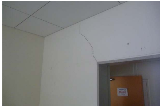
(d) 非構造壁の損傷-2
