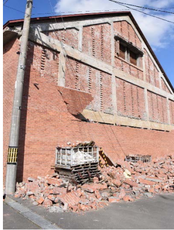
写真 2.7 外壁の被害事例 (厚真町)
