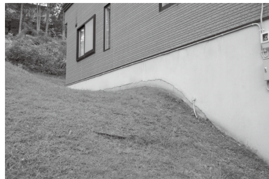
写真 3.16 神社の南側斜面のすべり
