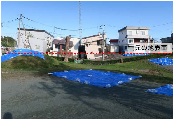
写真4 札幌市清田区里塚地区の地盤沈下状況
