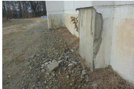
(d) 基礎梁の仕上げモルタルの剥落
