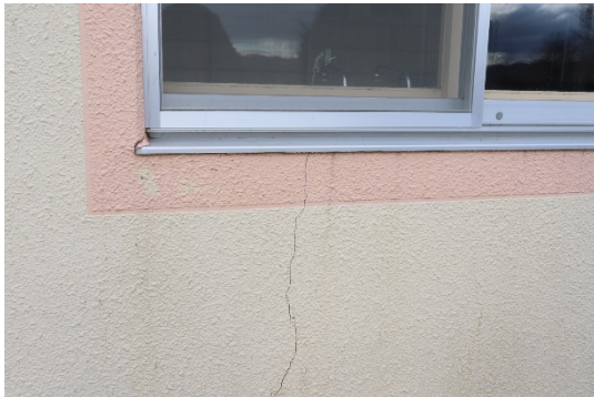
写真 2.5 腰壁に生じたひび割れ(C3)
