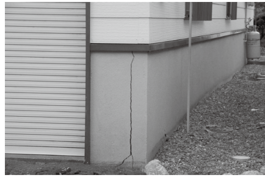
写真 3.18 基礎に一部ひび割れ
