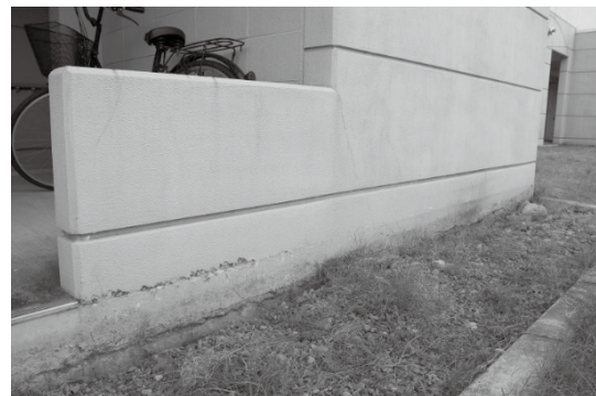
写真 3.14 建物 B の共用部分での損傷
