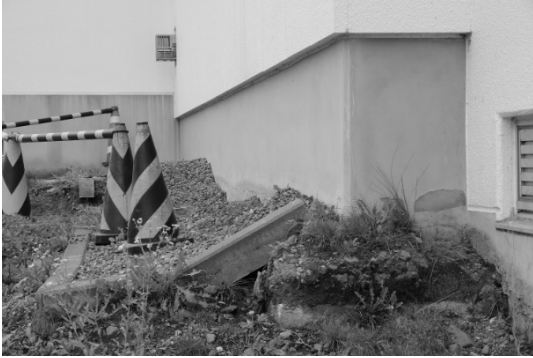
写真 3.21 地盤沈下に伴う埋設管の隆起
