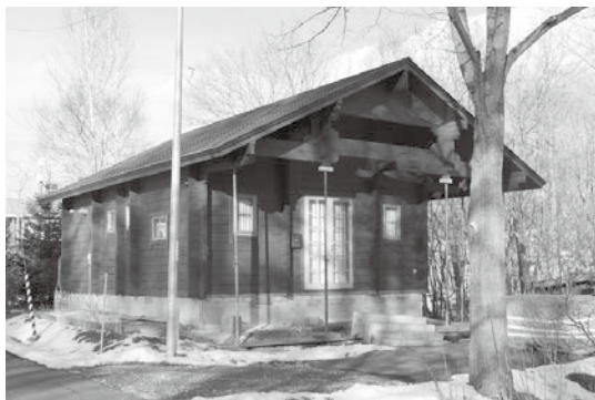
写真 3.10 地盤の変動によって損壊したと思われる住宅（正面のデッキ部分の撤去後）
