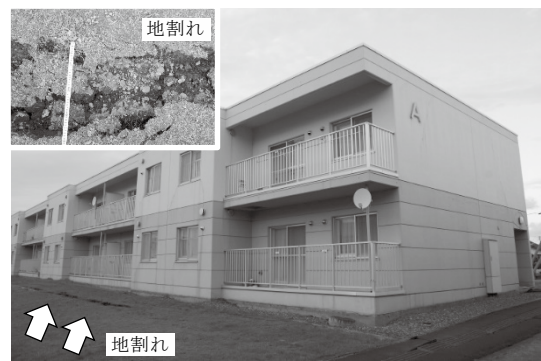
写真 3.12 RC 造 2F 建物 A の全景と地割れ
