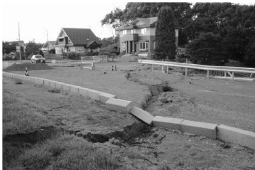
写真3.1 整備中の道路に生じていた地割れ
