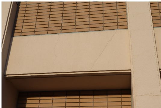
(a) 梁および柱のひび割れ
