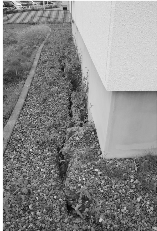
写真 3.23 基礎フーチング周辺の地盤変状
