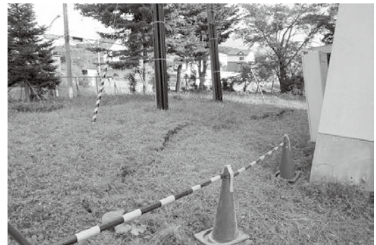
写真 3.7 敷地東側での地割れ
