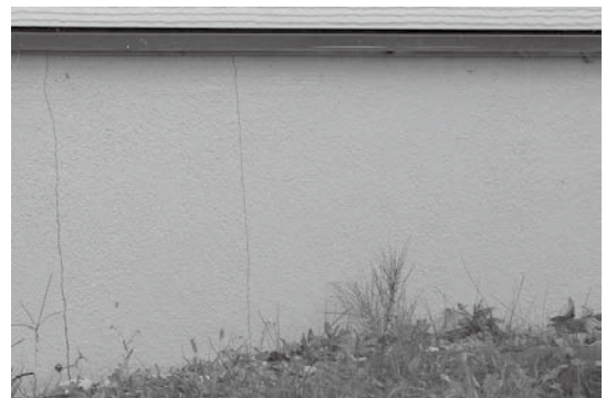
写真 3.9 基礎に一部ひび割れ
