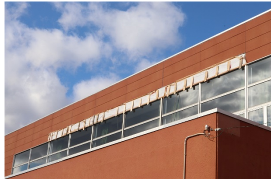
写真 2.6 外壁の剥落(C4)
