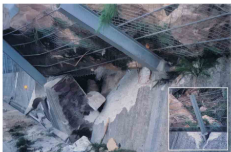
写真-1 支柱基部の損傷例 3)
