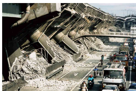
写真-1 阪神高速道路3号線の倒壊したピルツ橋脚 1)
