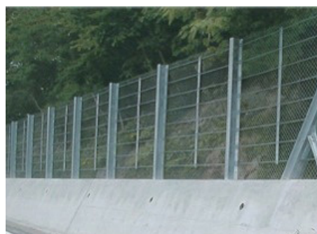
写真-1 従来型落石防護柵の一例
