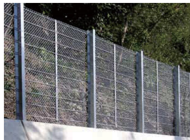
写真-1 従来型落石防護柵の一例
