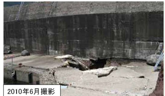
写真-3 護岸背後の被災状況
