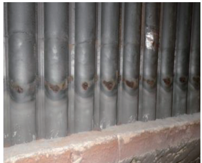
写真1 キャスタブル直上の火炉水冷壁パネル損耗状況の一例
