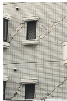
写真1 近年の二次壁の損傷被害の例
