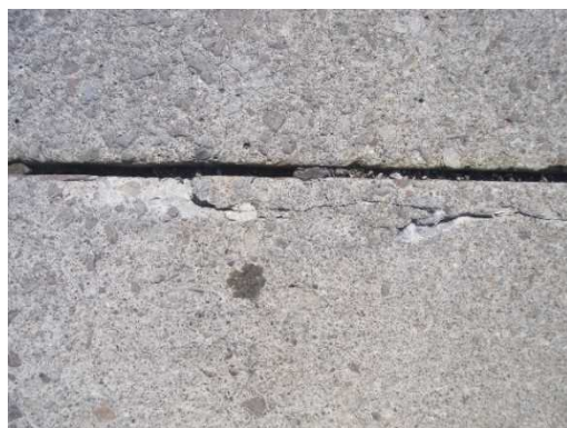
写真-3.4.1 目地部の損傷
