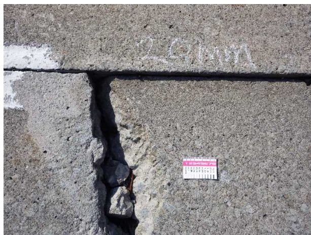
写真-7.1.2 コンクリート舗装版の沈下に伴う段差(20 mm)
