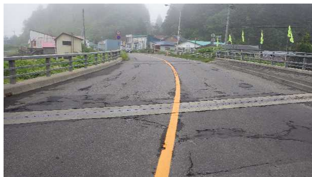
写真-8.3.2 橋梁部の舗装損傷
