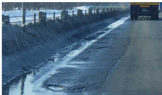
写真-8.3.1 ひび割れへの水の浸入およびポットホールの発生
