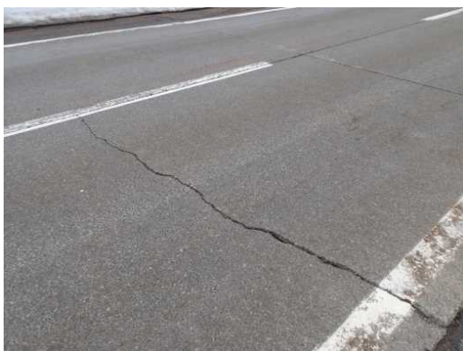
写真-3.4.3 横断ひび割れ
