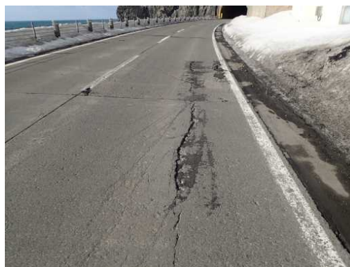
写真-3.4.4 縦断ひび割れ
