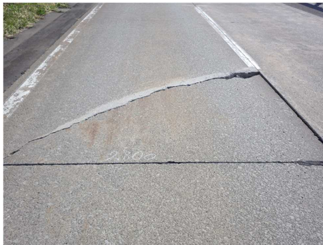
写真-7.1.1 コンクリート舗装版の局部沈下
