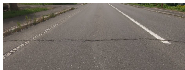
図-3 低温ひび割れの例
