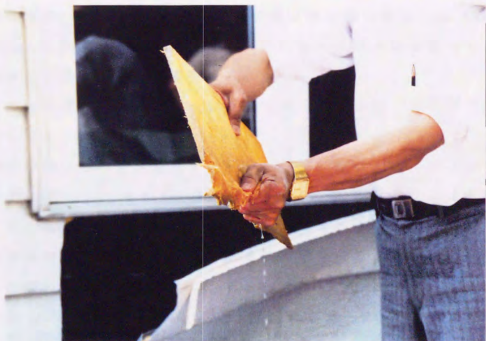
図 1 - 9 C 宅外装材裏面に取り付けられていたグラスウールの状態。7月にもかかわらず、結露水が断熱材を湿潤させている。
