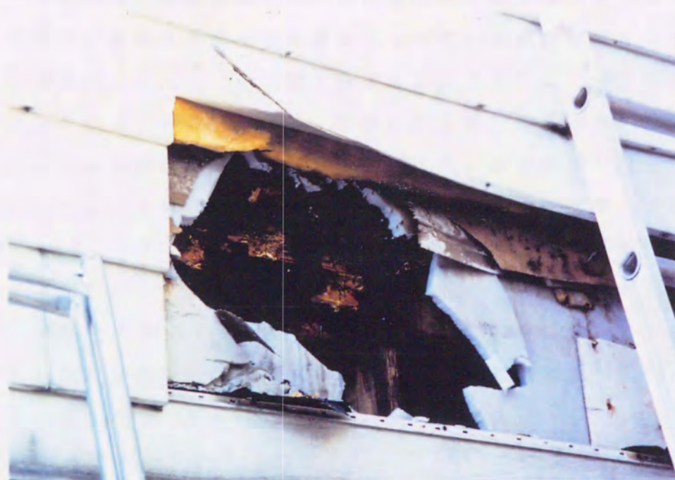
図 1 - 8 C 宅の外装（アルミサイディング）を剥した状態。一部断熱材が不足し、軸組の腐朽が進行している。
