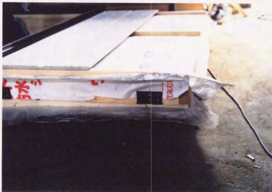
図 5 - 11 外壁パネルにサイディングを施工後、 側板に受け金物を取付けた状態
