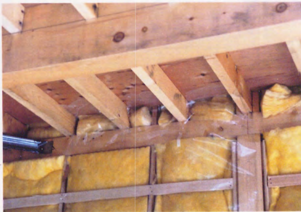
図1-11 外壁と2階床部分の気密・防湿材（ポリフィルム）と、断熱材の納まり状態。気密・防湿材が欠損し、断熱材の連続性を保つには容易ではない。
