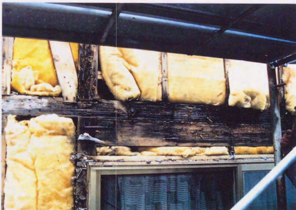
図 1 - 5 A 宅の主要軸組の状態。柱、桁の腐朽が認められ、構造的にも危険な状態。
