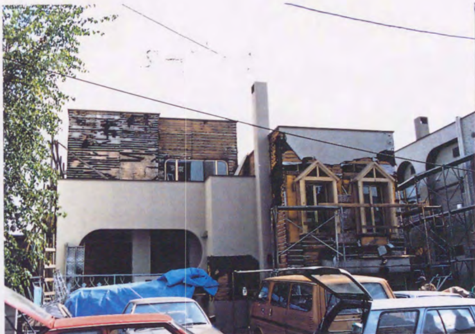
図 1 - 4 A 宅のモルタルを剥した状態。外観は異常が認められなかったが、下地板の腐朽が進んでいる状態。
