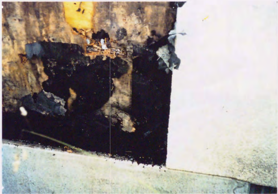
図 1 - 7 B 宅 1 階北側外壁パネル内部。内部結露によりパネル下部の構造用合板、下枠が腐朽している状態。
