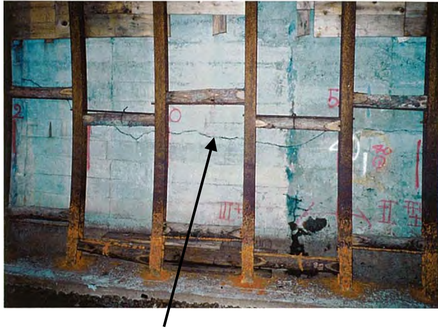
水平方向のクラック
