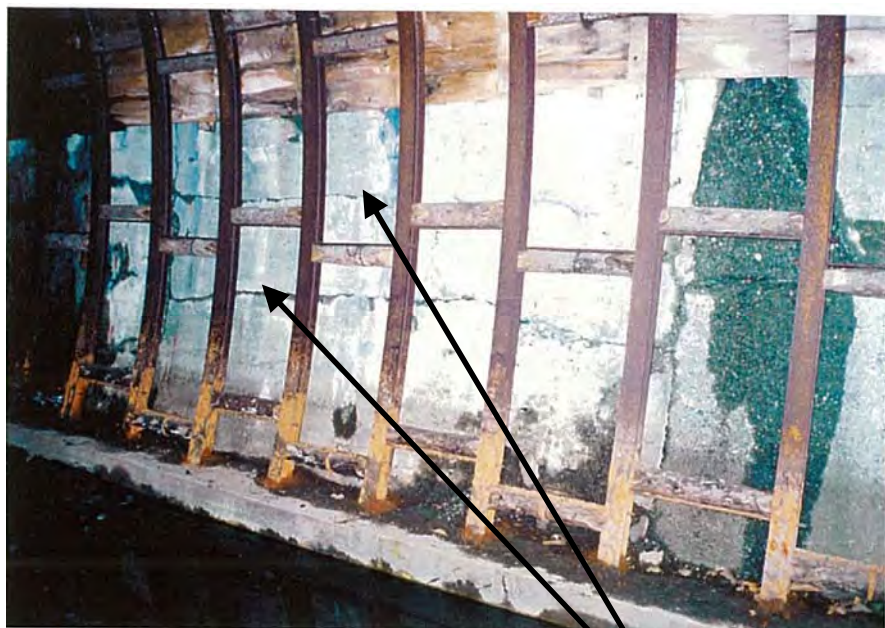
水平方向のクラック
