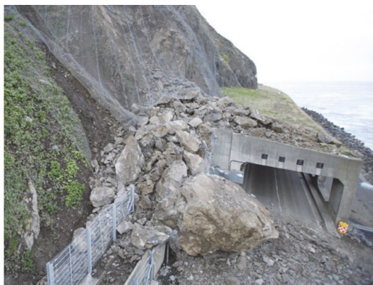
写真-1.2 落石による被災事例 (2008)
