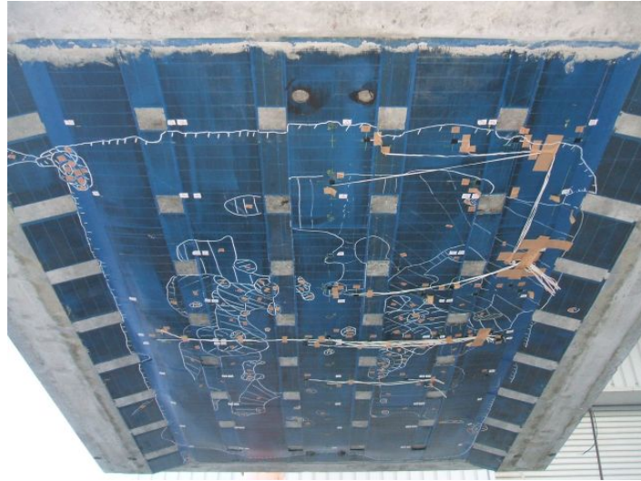
写真 6-3 No.2 実験終了時の下面の状況
