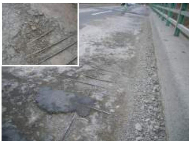
写真 1-1 床版上面のスケーリング
