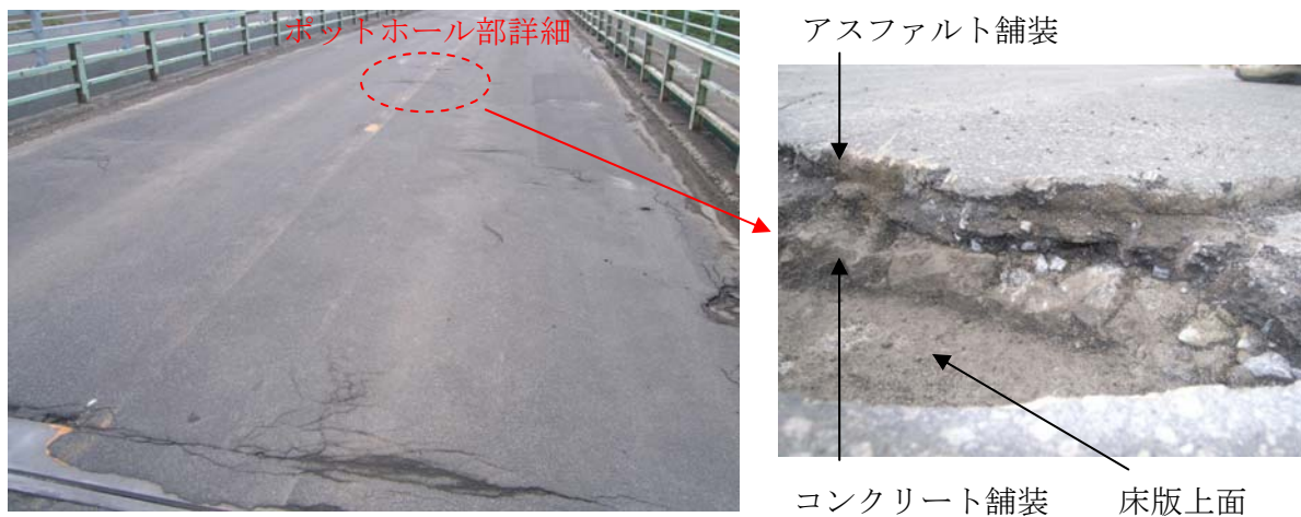
(a) 床版上面の劣化状況
