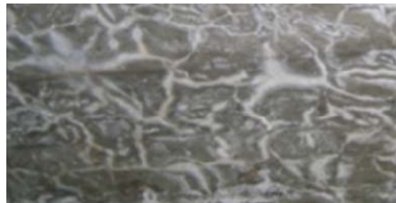
(b) 床版下面の劣化状況（エフロレッセンス）
