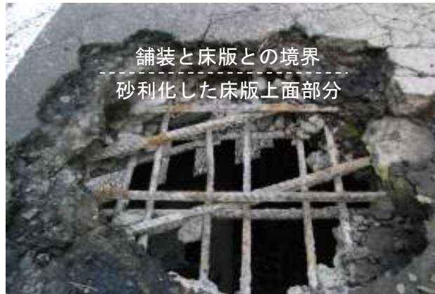
写真 1-3 砂利化後の押抜きせん断破壊
