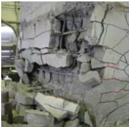
写真 - 6 2.0-M-7 試験体損傷状況
