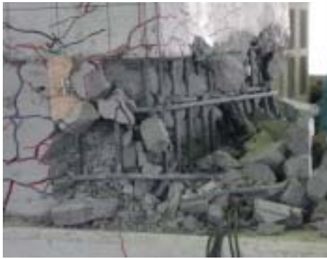
写真 - 5 2.0-M-5 試験体損傷状況
