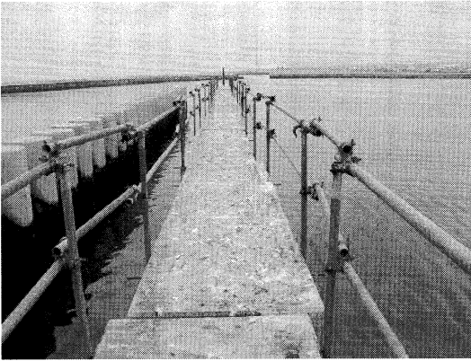
写真-1 直立部の滑動被害の状況
