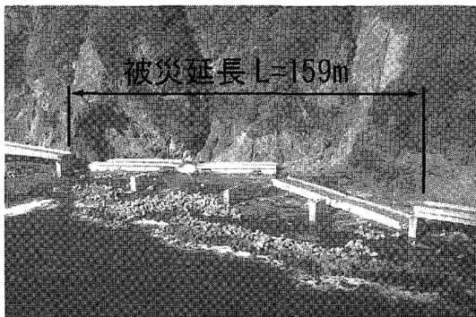
写真-1 大森大橋の被災状況
