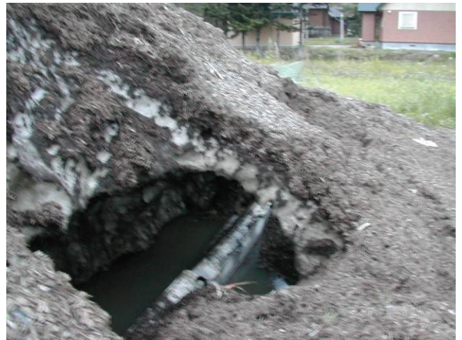
Fig.5.3 風洞の崩壊状況
