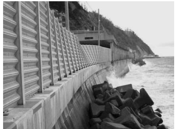
写真-2 防波フェンスの損傷状況(A区間)
