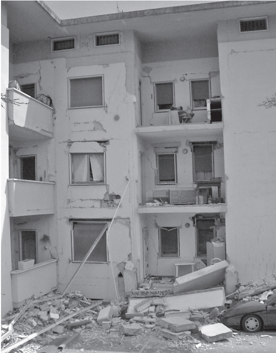
図4：ラクイラ市内の一階が潰れたアパート
