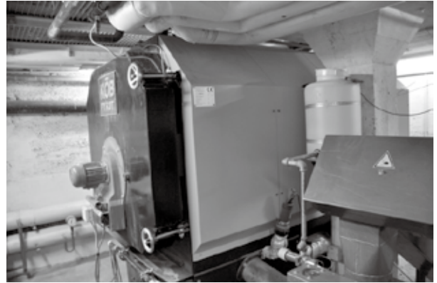
図 3 おがくずペレットボイラー
