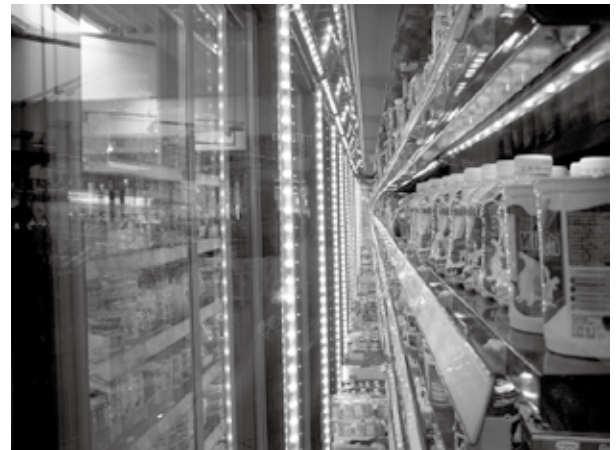
図12 店内の冷蔵ショーケース内の照明はLEDが使われている。片側の壁がすべて冷蔵ショーケースであり、熱損失を少なくするための工夫が凝らされている (6) 。
