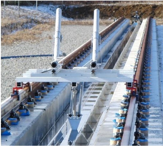
図5 減速水路に浸された制動板（バケット）
