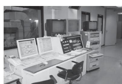
(c) 風洞試験装置の中央制御盤
