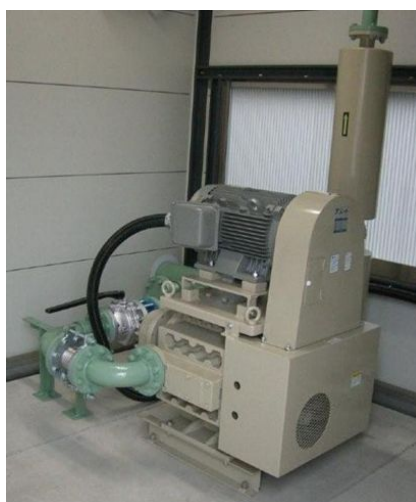
図 9：増設した真空排気装置
