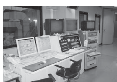
(c) 風洞試験装置の中央制御盤
