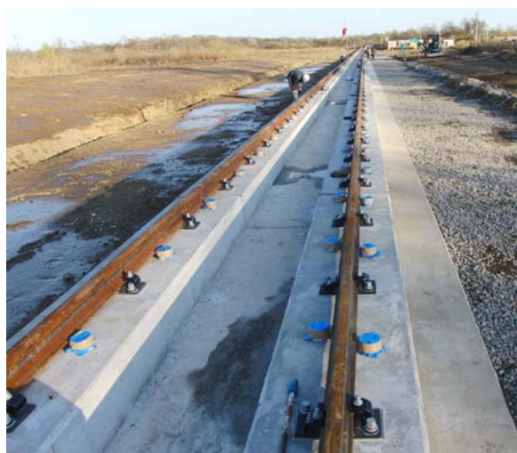
図1 白老エンジン実験場に設置したフルサイズ高速走行軌道実験設備(軌道長:300m)
