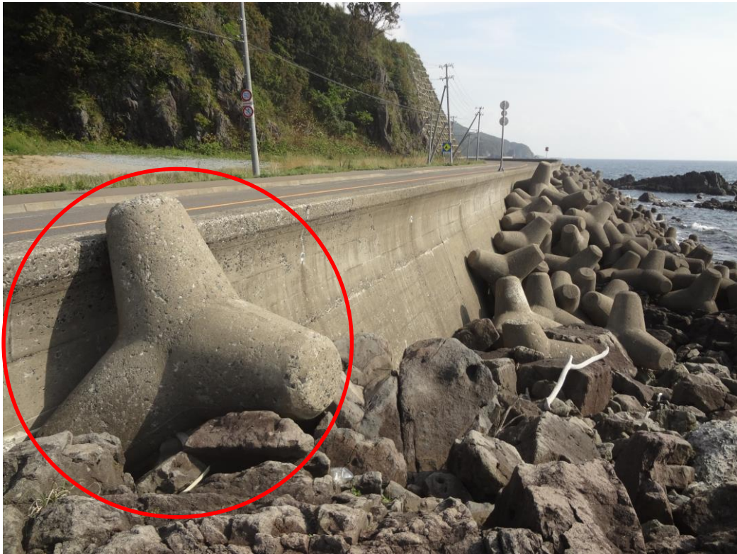
写真-3.1.2.4 高波浪時の波の外力により飛散したと予想される消波ブロック
