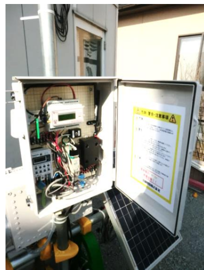
図6 設置したシステム機器(A)
