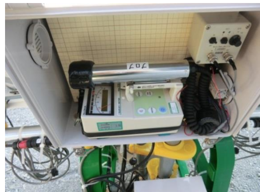
図5 設置したシステム機器(B)
