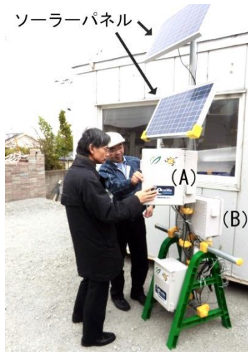
図4 設置システムの機器収納の様子
