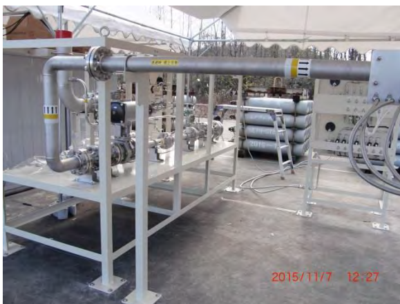
図1 GG-ATR エンジン冷走試験設備
