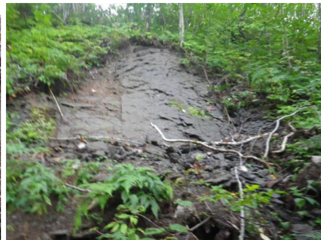
図 13 崩壊箇所上部の溶結凝灰岩
