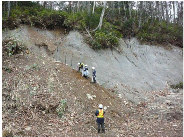
図 11 地点 2 崩壊箇所の正面全景
