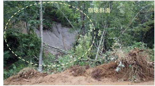
図6(a) 地点2の崩壊箇所全景
