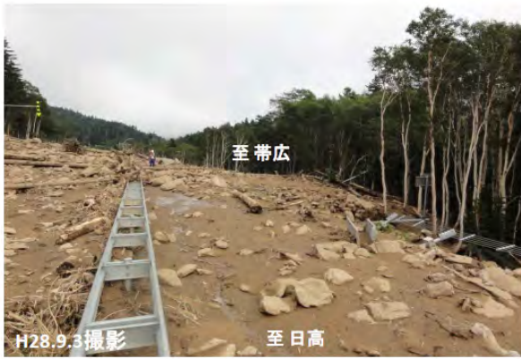
図6 No.27 付近の盛土崩壊状況
