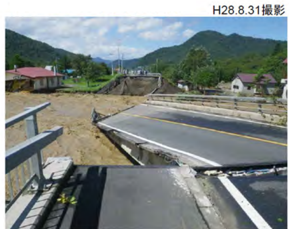
図11 No.1 千呂露橋の落橋状況 (1)
