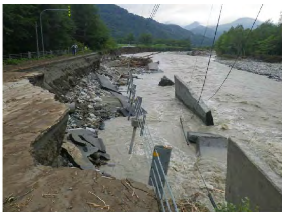
図10 No.2 千坂擁壁の洗掘による崩壊状況 (1)
