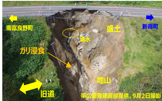
図 13 国道 38 号狩勝峠 盛土崩壊状況
