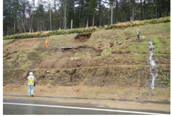
図7 No.27 付近の切土崩壊状況
