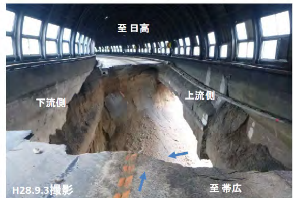
図5 国道274号三国の沢シェルター崩壊状況 (1)
