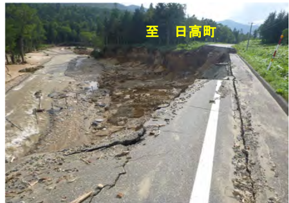
図9 No.20の盛土崩壊状況 (1)
