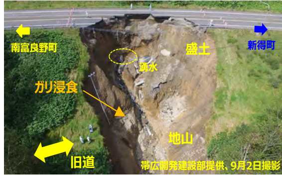
図 13 国道 38 号狩勝峠 盛土崩壊状況
