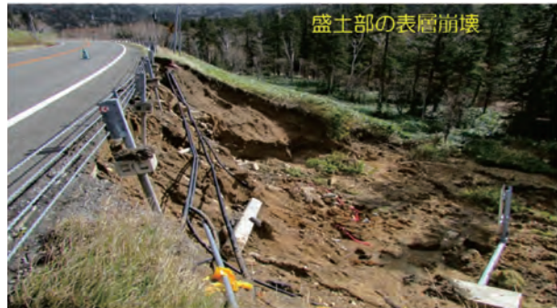
写真 1 日勝峠 (日高町側) 9 合目付近の土砂災害の状況 : (上) スノーシェルター下部の支持地盤の土砂が流出、(下) 盛土部の表層崩壊
