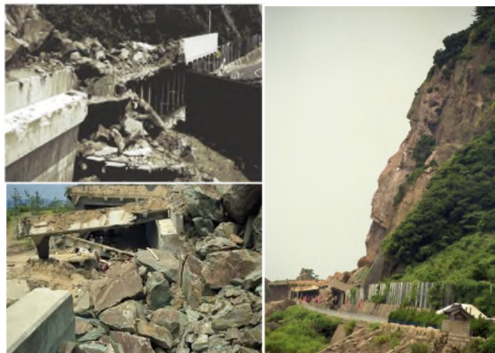
写真-1.1 福井県越前町一般国道305号越前海岸落石事故（1989年7月）
