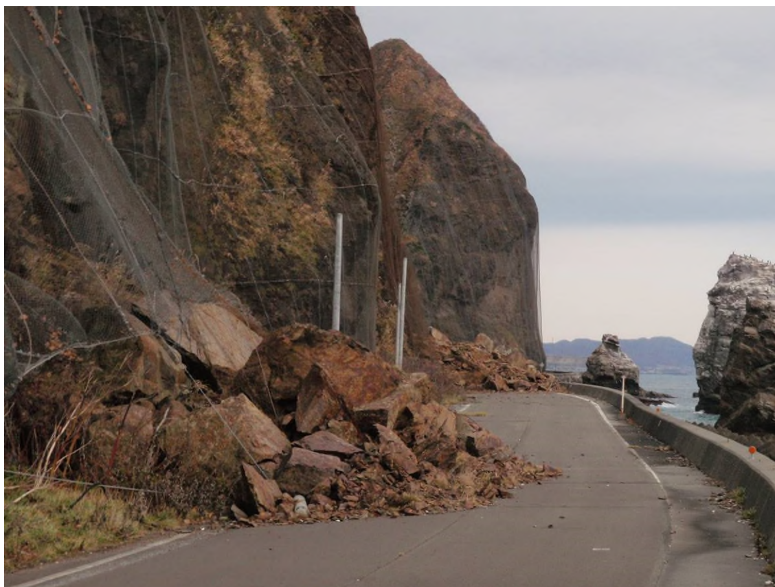
写真-2.4 北海道の旧国道の落石状況
