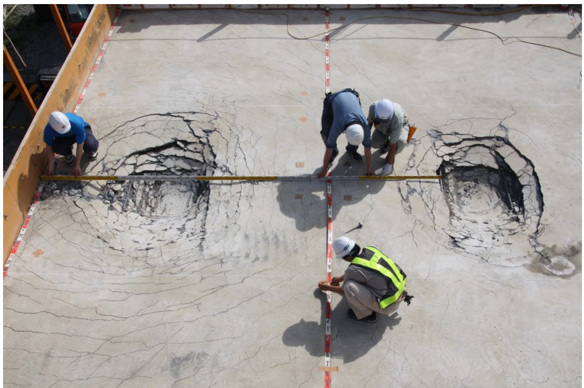
(a) TLAS 芯材 RC 版の損傷状況
