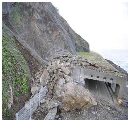
写真-1.3 北海道増毛町一般国道231号湯泊覆道岩盤崩壊事故（2008年5月）
