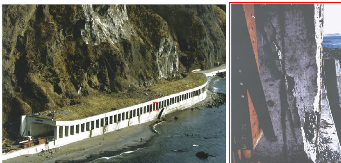
写真-1.5 北海道様似町一般国道 336 号ランベツ覆道岩盤崩落事故 4), 5)
