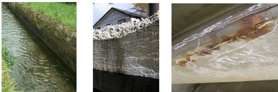
写真 1-1-1 コンクリートの劣化事例
