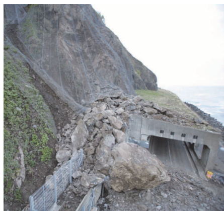
写真-1 落石による災害事例 (2008)
